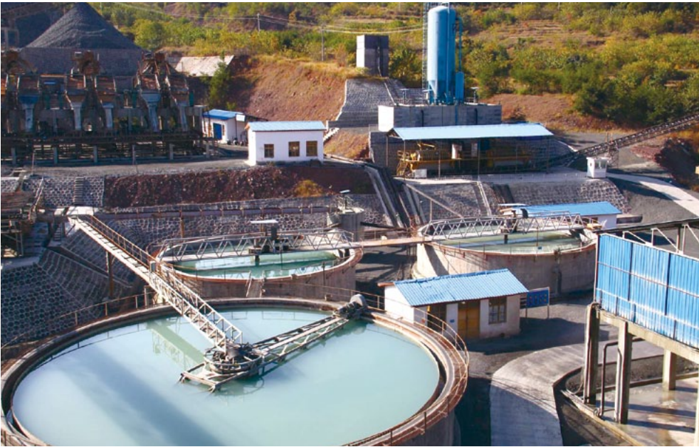
水电工程施工区的生活污水处理站
